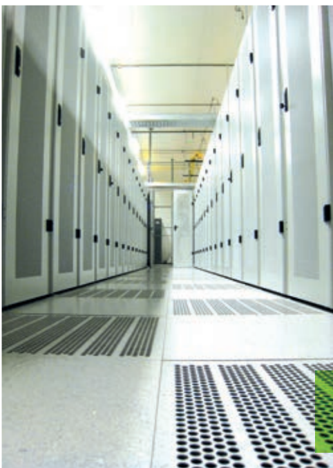
Nerim est présent, entre autres, dans le data center Equinix PA3 de Saint-Denis, près de Paris.
